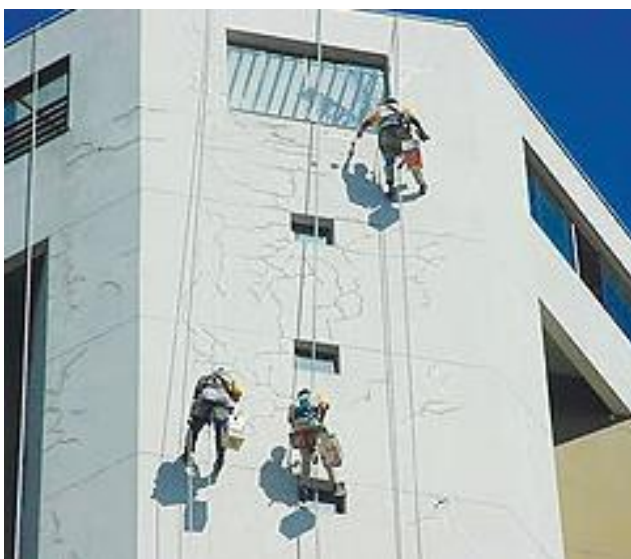
Figura 12. Fissura mapeada causada pela retração da secagem da argamassa
