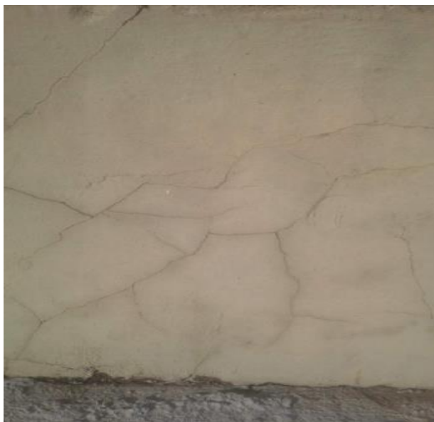
Figura 6. Fissuras mapeadas em parede externa
