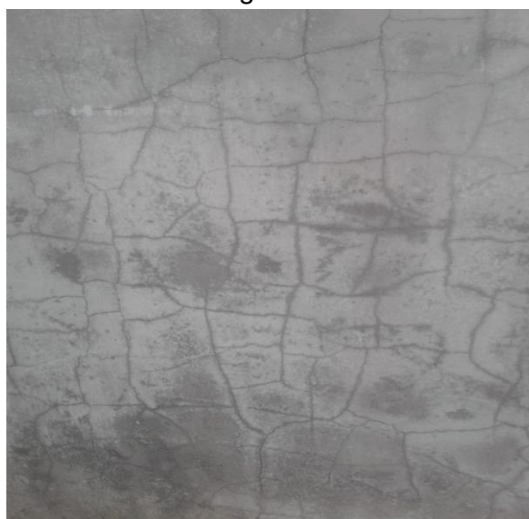
Figura 11. Constatação da fissura mapeada após falha na técnica da aplicação da argamassa
