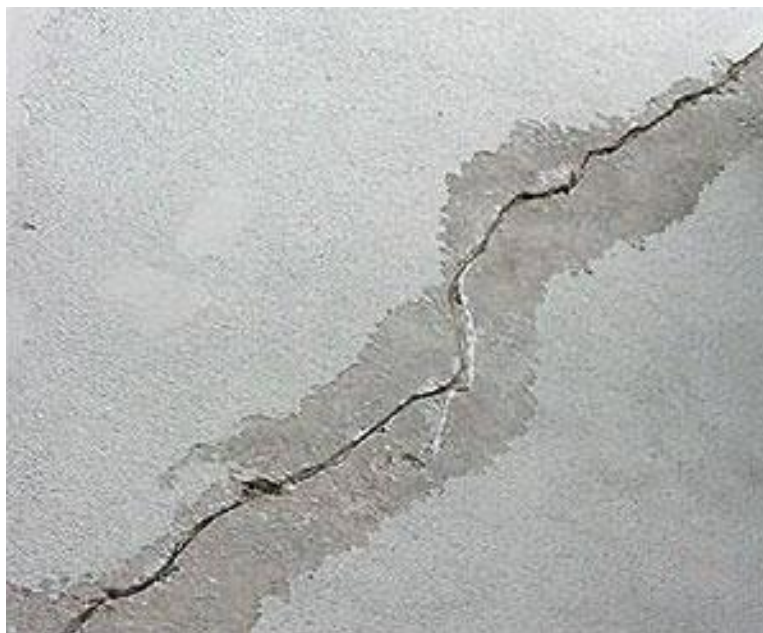
Figura 5. Fissura em parede
