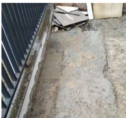
Imagem 4 Ausência da manta
