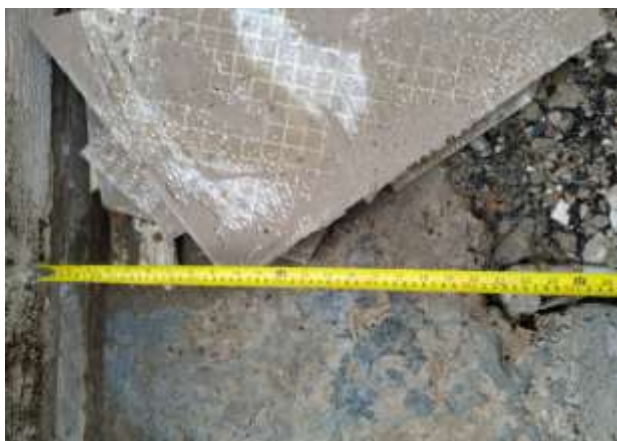
Imagem 5 medida da mureta da sacada
