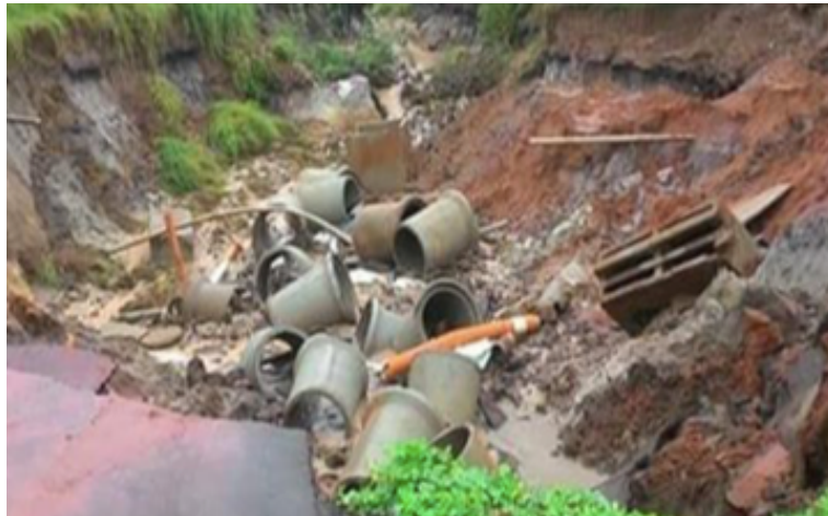
Figura 4 - Desbarrancamento e erosão devido a falha de dimensionamento, onde o volume solicitado ultrapassou os limites do volume projetado. Fonte: g1.globo (2016).
