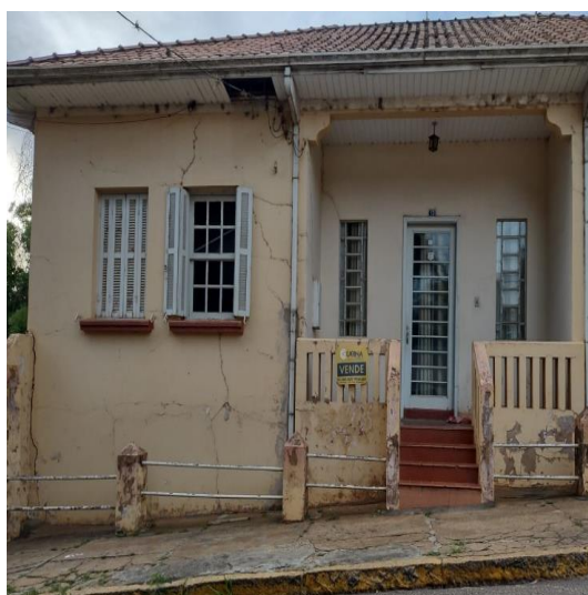
(C) Fissuras na fachada residência - (autora)
