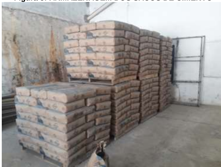
Figura 5: ARMAZENAGEM DOS SACOS DE CIMENTO
