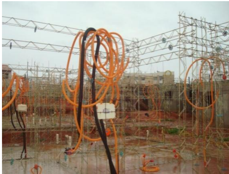
Figura 13. Eletrodutos, caixas elétricas e espaçadores. Fonte: SANTOS (2013).
