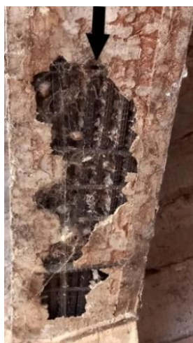
FIGURA 5 - Cobrimento insuficiente de concreto na viga da ponte localizada na Rua Curuzu Botucatu, SP.
