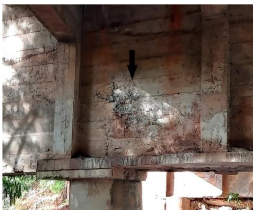
FIGURA 8 – Segregação no concreto na ponte localizada na Rua Curuzu Botucatu, SP.
