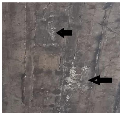
FIGURA 7 - Manchas de carbonatação no tabuleiro da ponte localizada na Rua Curuzu Botucatu, SP.
