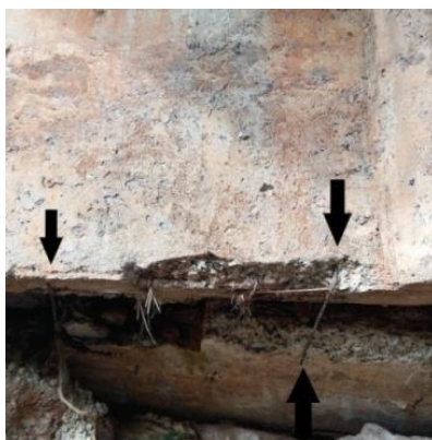
FIGURA 6 - Corrosão da armadura exposta da ponte localizada na Rua Curuzu Botucatu, SP.
