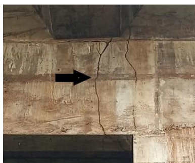
FIGURA 9 -Fissura na viga do viaduto localizado na Rua Curuzu Botucatu, SP.
