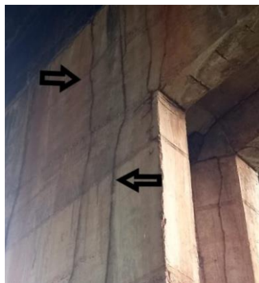
FIGURA 10 - Trinca na viga e pilardo viaduto localizado na Rua Curuzu Botucatu, SP.
