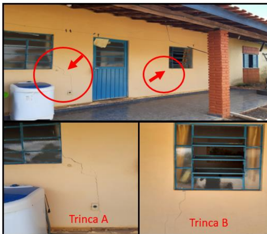
Figura1: Trincas no reboco e alvenaria.
