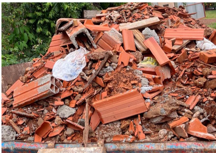
Figura 5. Entulho gerado por um dos locatários – construção, em Jaú, SP.
