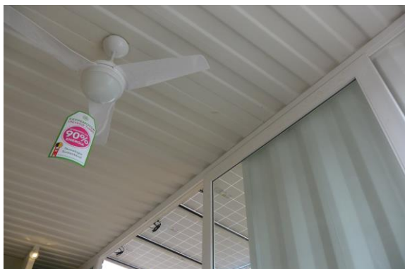
Figura 13: Chapa metálica com pintura anti térmica
