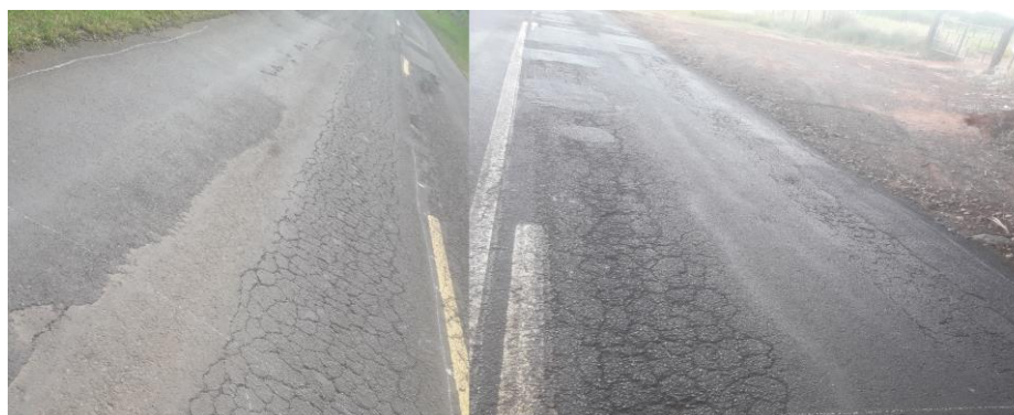
FIGURA 06 – Defeitos: Afundamentos, trincas FC-03, remendo e desgastes.
