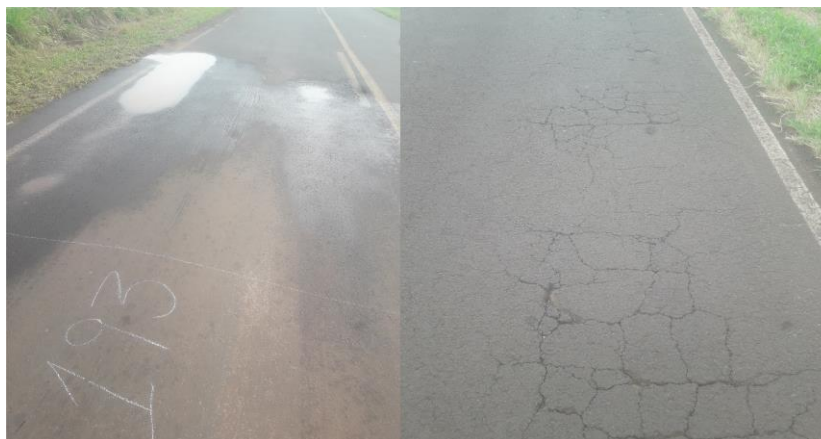
FIGURA 08 – Defeitos: Afundamentos, desgastes e FC-03.
