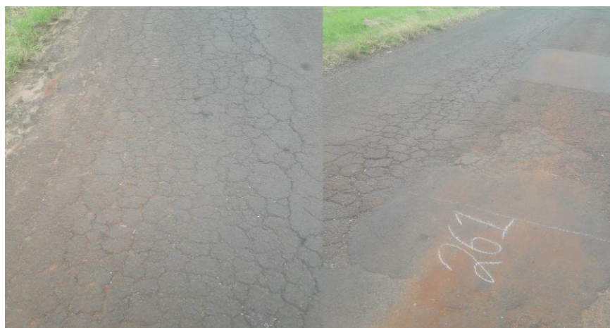
FIGURA 05 – Defeitos trincas FC-03 desgastes e remendo.
