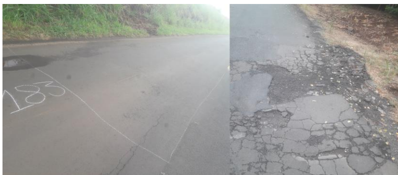
FIGURA 07- Defeitos: Escorregamento, afundamento, FC-03 e FC-01.
