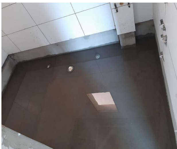
Figura 9. Teste de estanqueidade.
