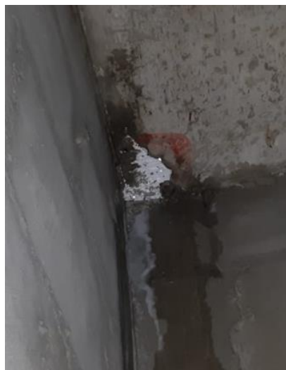
Figura 10. Vazamento no teste de estanqueidade.
