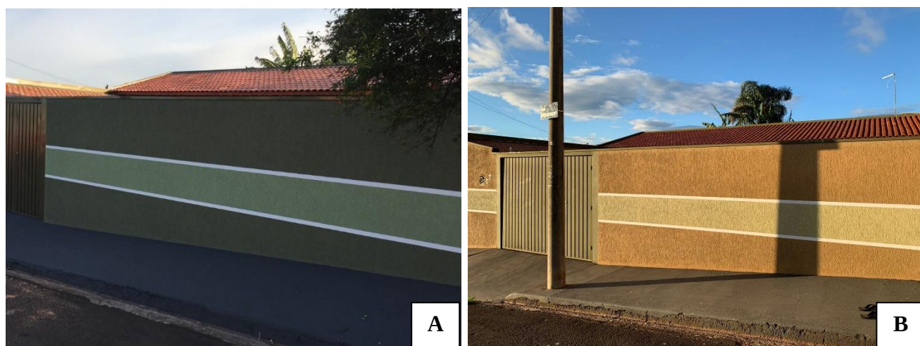
FIGURA 5 - Desbotamento de pintura. A. Local 2 - Pintura recém executada e; B. Local 2 - Pintura após 8 meses da aplicação.
