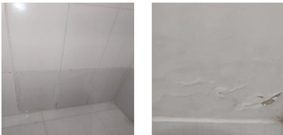
FIGURA 4 – Manchas no revestimento, apodrecimento e mofo na parede
