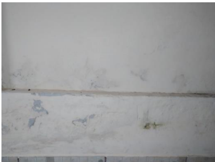
FIGURA 2 - Umidade por capilaridade
