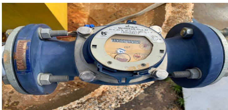
Figura 5 - Macromedidor da Base E.T.A
