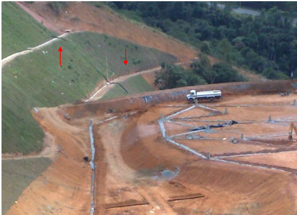
Figura 7. Canaletas de captação das águas pluviais
