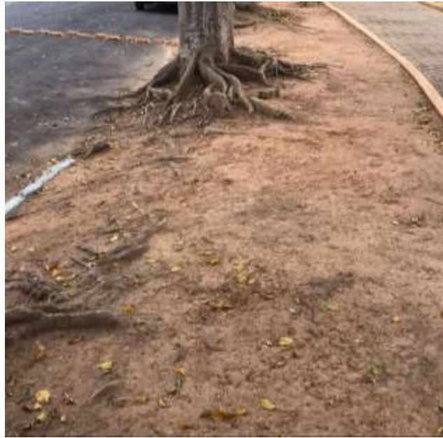
Figura 7: Pode-se observar a precariedade da calçada devido as raízes das vegetações locais.
